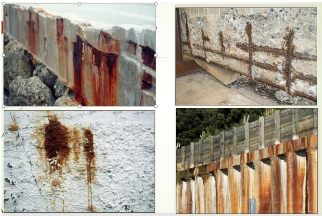
Slika 3. Korozija nezaštićenog čelika u betonu.
